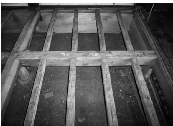
2、貫穴・間渡し穴の痕跡 写真 2-10、台所北側の太引当初転用材の痕跡
