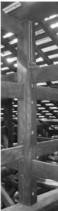
5、敷居・板決り 間渡し穴の 痕跡
