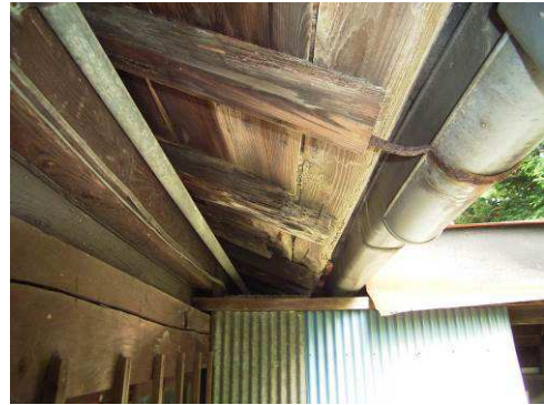
【写真 27】東側軒先雨腐れ
