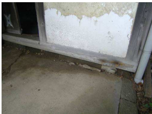
【写真166】土台蒸れ腐れ
