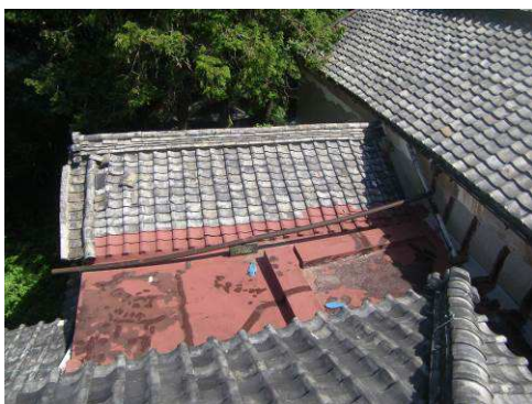
【写真 74】南流れ屋根状況
