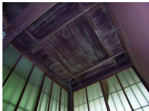
【写真 183】「便所」天井雨染み
