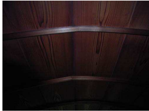
【写真 135】竿縁折損
