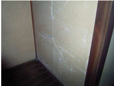
【写真 116】上塗り剥離
