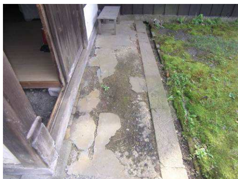
【写真 37】土間の割れ・剥離
