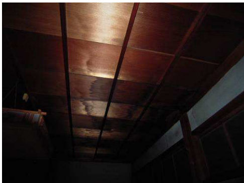
【写真 136】天井雨染み
