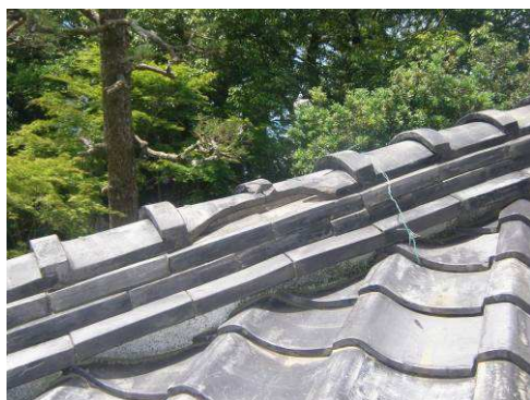
【写真 111】 雁振りの欠損
