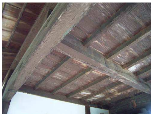
【写真43】通路天井の蟻害
