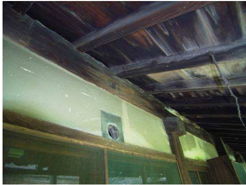
【写真 26】北側桁雨腐れ
