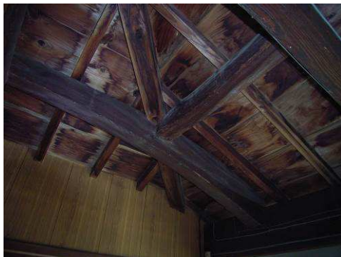
【写真 28】「南縁」天井雨染み
