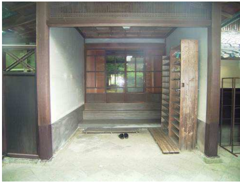
【写真 18】敷石表面剥離
