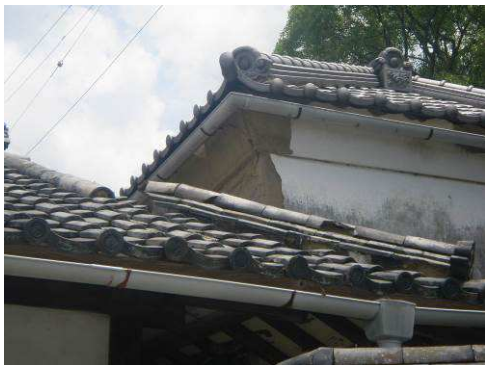
【写真 48】雁振り割れ
