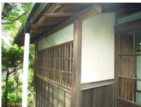
【写真 132】上塗り剥落・剥離
