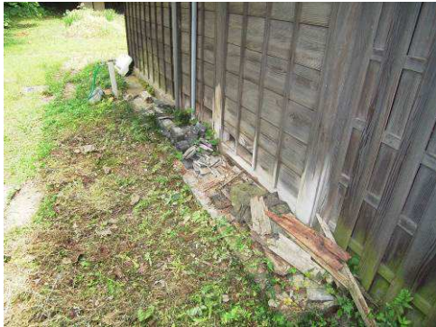
【写真 180】土台・柱脚蒸れ腐れ
