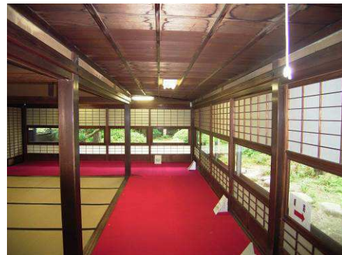
【写真 29】「広縁」天井雨染み
