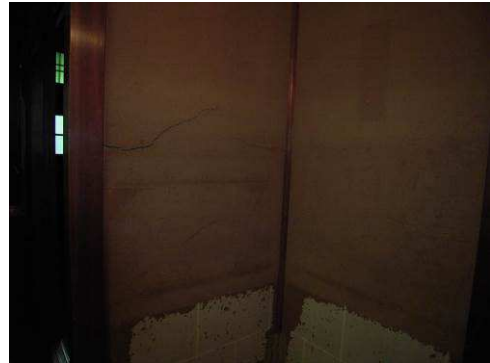
【写真 117】貫位置での割れ
