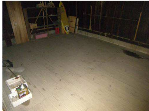
【写真 61】床板の雨染み
