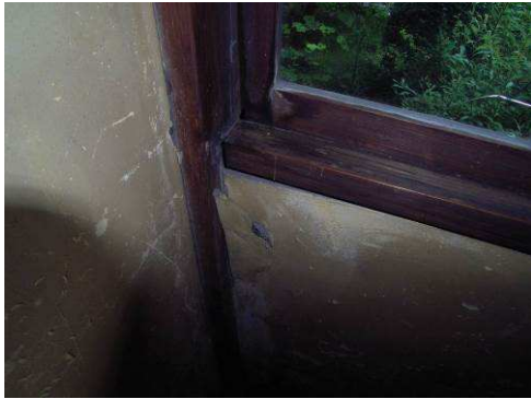
【写真 134】窓敷居弛緩
