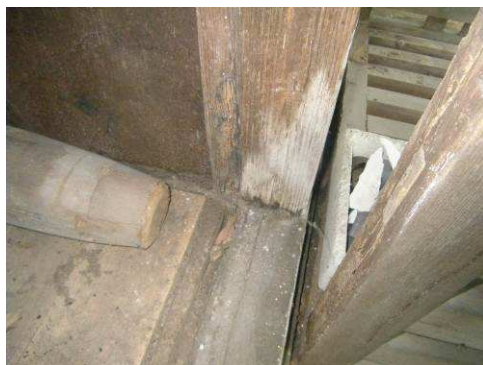
【写真167】柱脚蟻害
