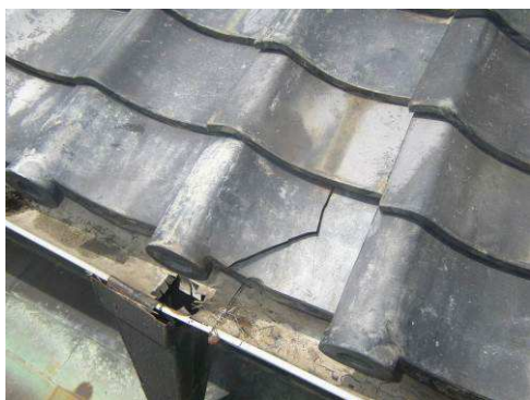
【写真 110】 軒瓦の割れ
