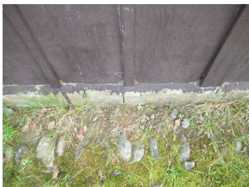
【写真146】防腐剤付着
