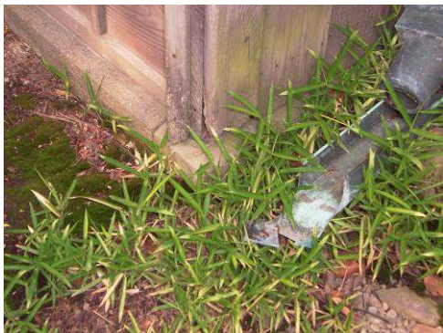
【写真 122】「物置」柱脚蟻害
