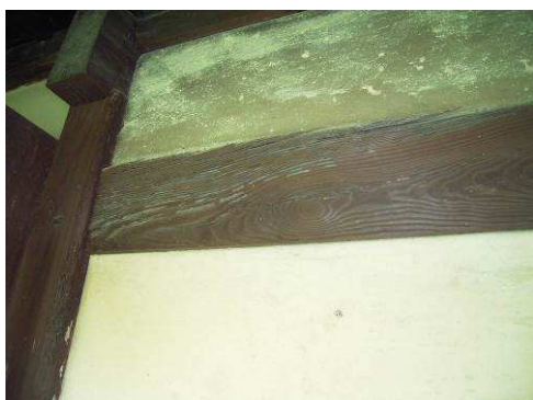
【写真 24】「食堂」差し鴨居蟻害
