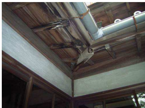
【写真 125】「中廊下 (南)」軒先雨腐れ
