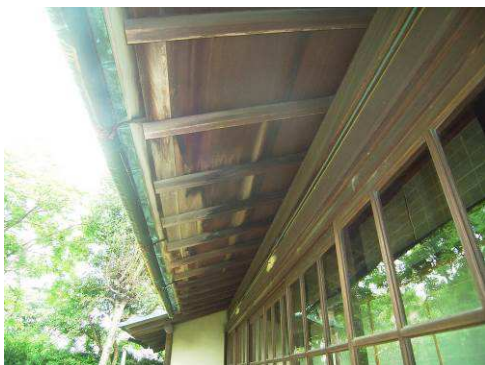
【写真 124】「縁 (西)」軒先雨腐れ
