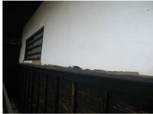
【写真 53】 防腐剤付着
