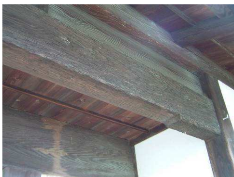
【写真44】差し鴨居の蟻害
