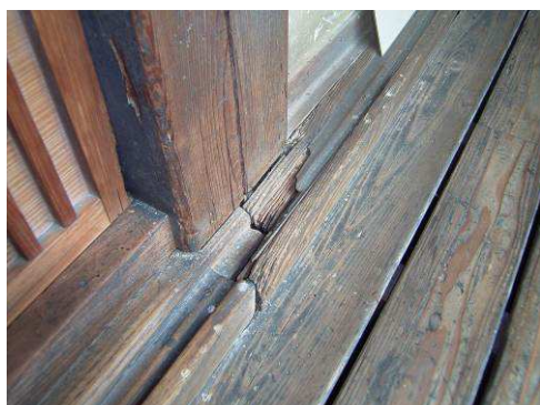
【写真 25】「北縁 (西)」一筋蟻害
