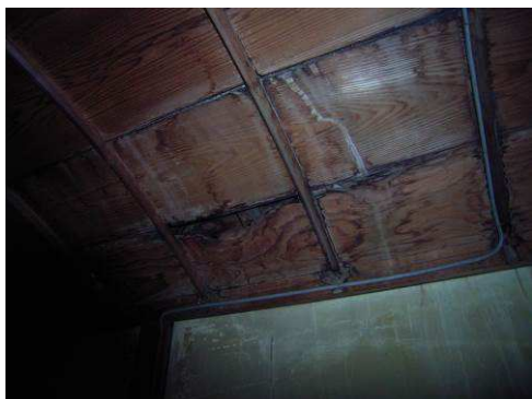
【写真 128】天井雨染み
