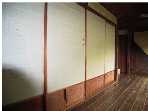
【写真 145】 腰板の割れ
