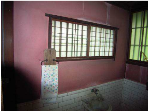
【写真 186】 壁雨染み
