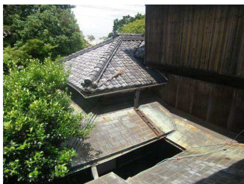
【写真 113】 銅板の腐食
