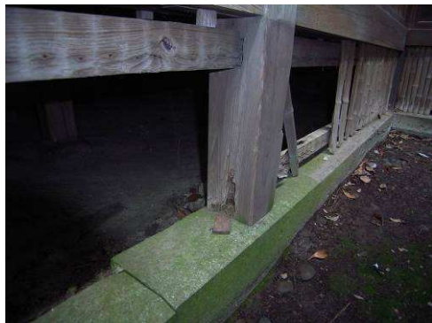
【写真 123】「中廊下 (南)」柱脚蟻害
