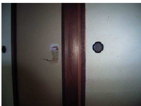
【写真 144】 引手金物の欠失
