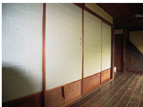
【写真 145】 腰板の割れ
