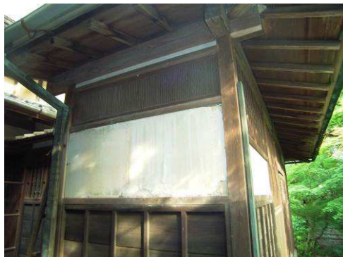
【写真 115】 上塗り剥離
