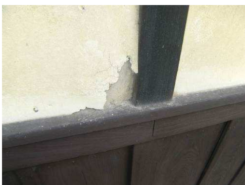
【写真 152】上塗り剥離
