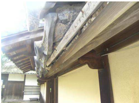
【写真 150】面戸剥落
