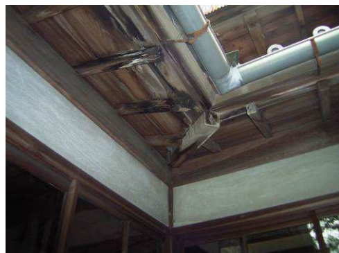
【写真 125】「中廊下 (南)」軒先雨腐れ
