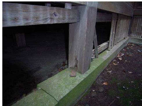
【写真 123】「中廊下 (南)」柱脚蟻害
