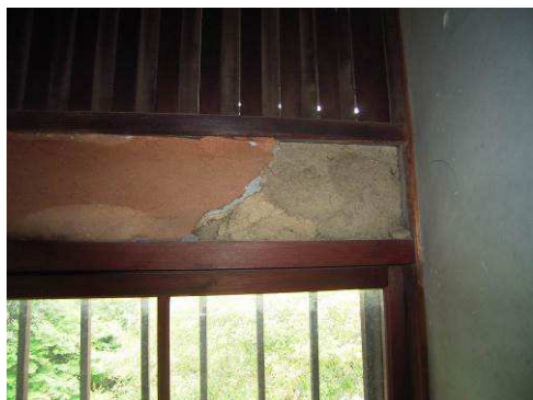
【写真 143】 「板間」上塗り剥落
