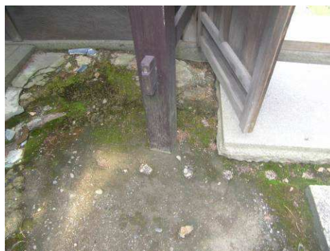
【写真147】控柱礎石欠失
