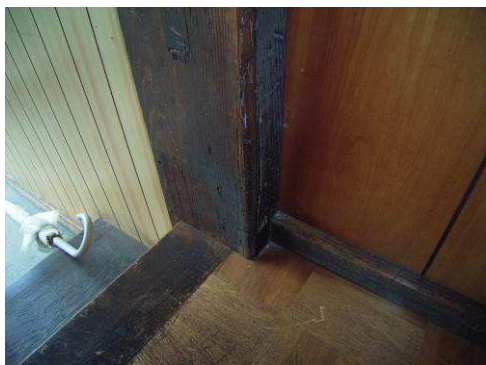
【写真22】「土間」柱蟻害
