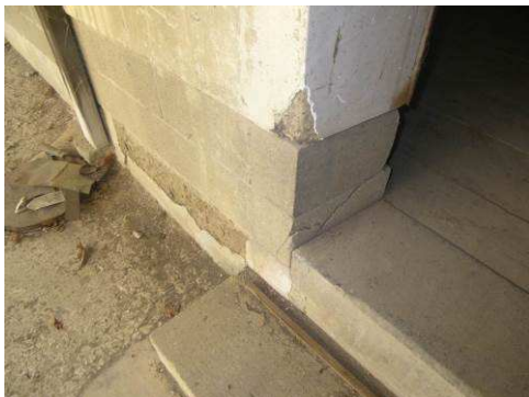
【写真 58】礎石の表面剥離
