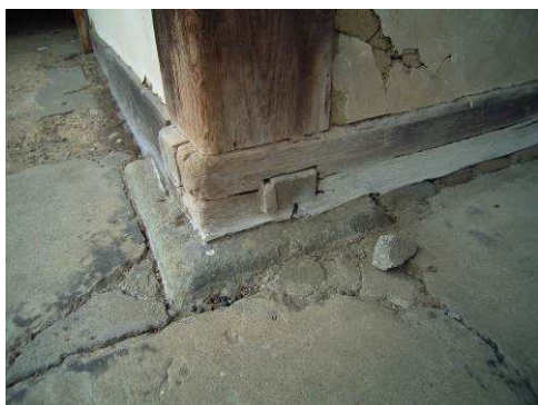
【写真42】土台の割れ・蒸れ腐れ
