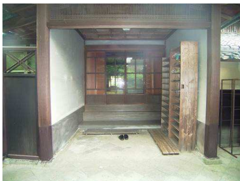
【写真 18】敷石表面剥離
