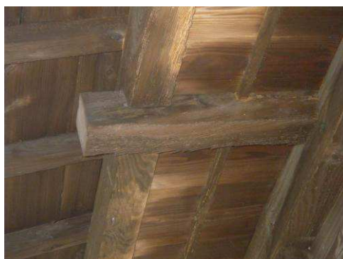
【写真45】腕木の蟻害
