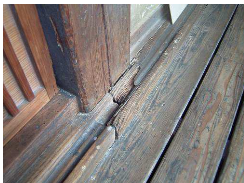
【写真25】「北縁(西)」一筋蟻害
