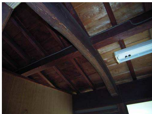
【写真23】「土間」梁蟻害
