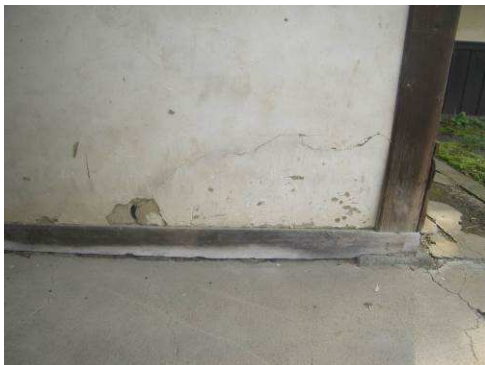
【写真 50】上塗り剥離・汚損
