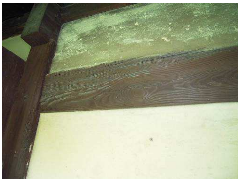
【写真24】「食堂」差し鴨居蟻害
